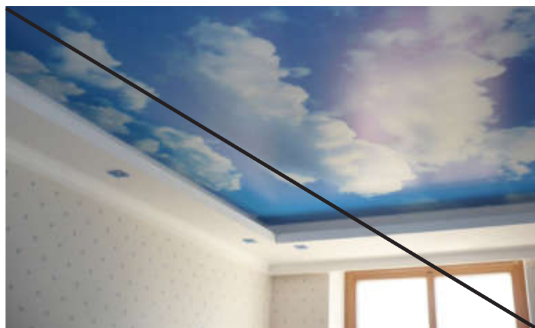
Плохо Натяжные потолки. Потолки с рисунками
